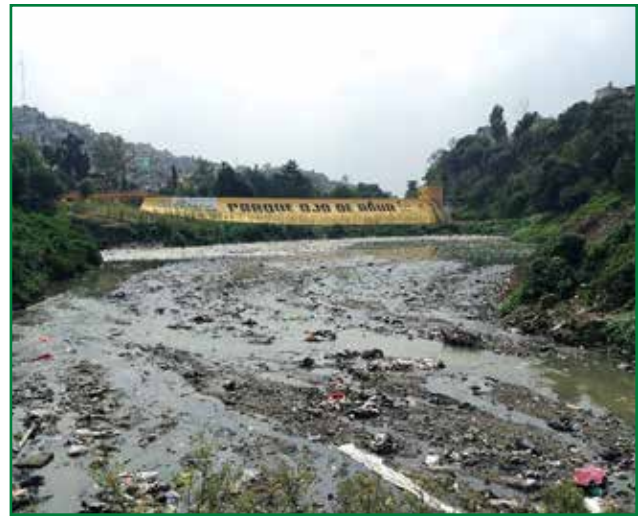
FIGURA 11. Presa C de Becerra para control de avenidas (nótese el azolve y basura que han comprometido la capacidad de almacenamiento)
