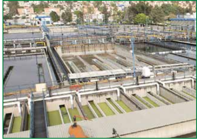
FIGURA 19. Planta de tratamiento de aguas combinadas Cerro de la Estrella
