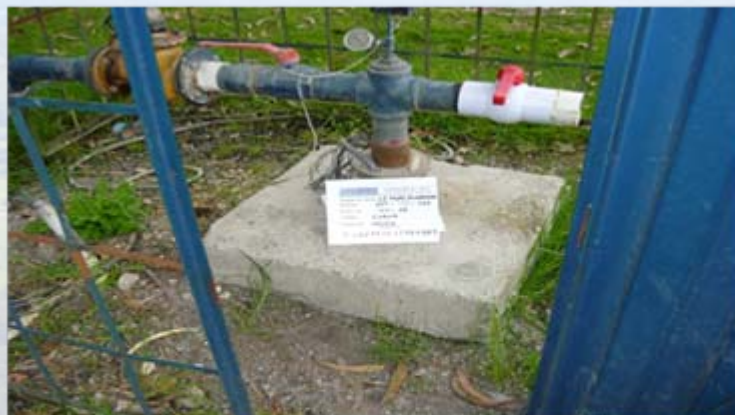
Automatización Red de Monitoreo niveles piezométricos y calidad de agua subterránea
